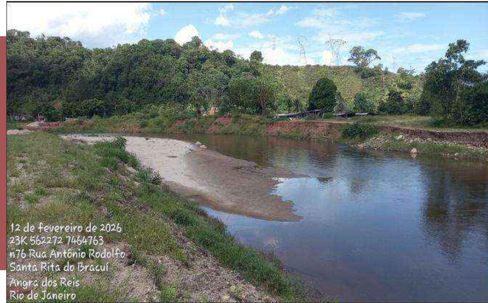
Vista lateral do talude erodido (ponto 11).
