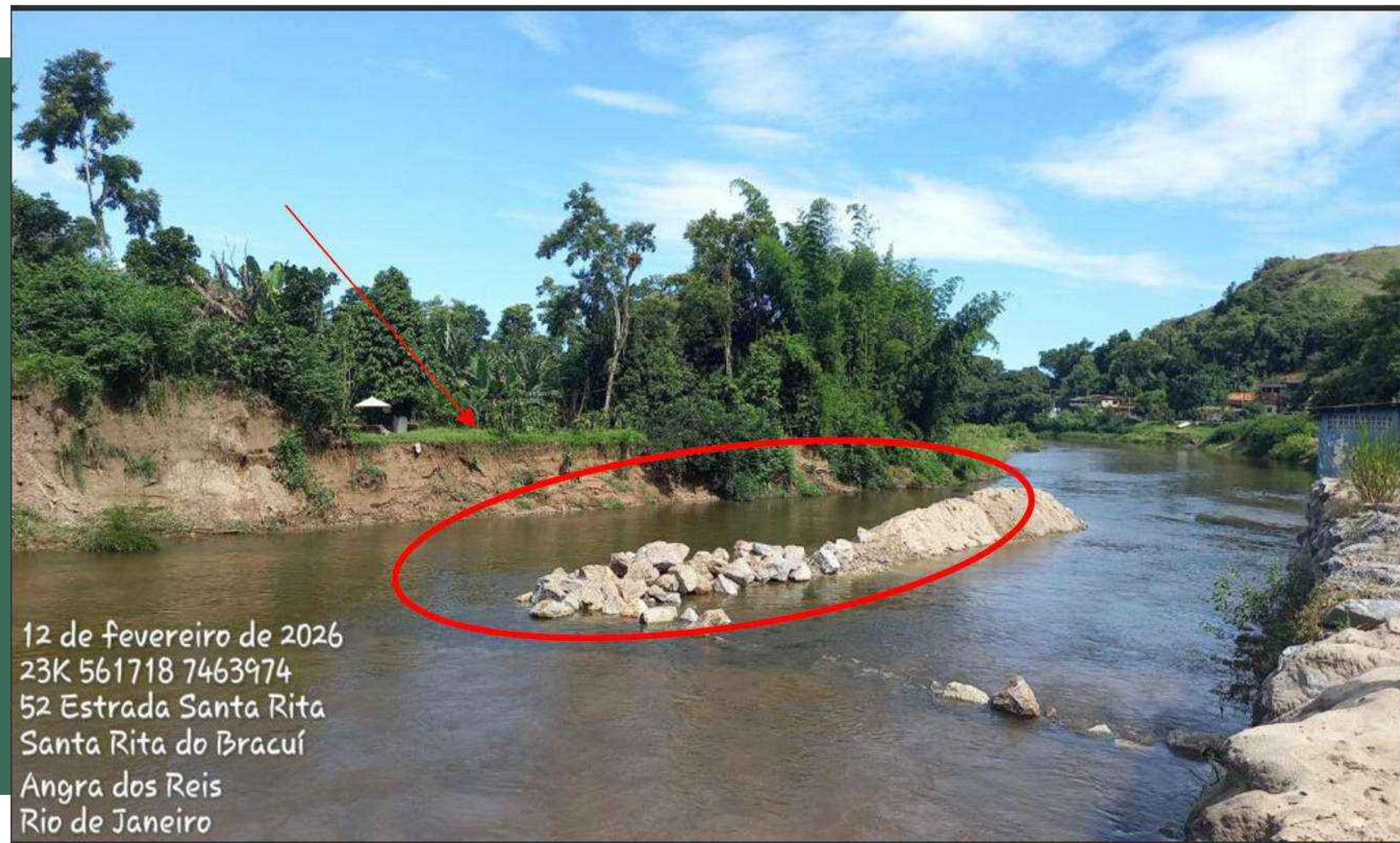
Sistema de captação e talude erodido.
