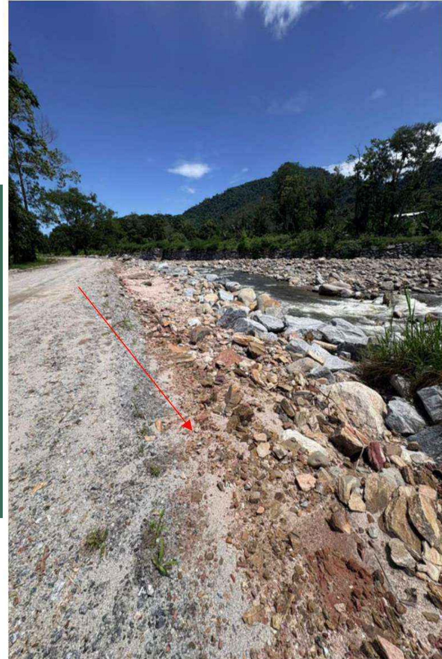
Área erodida na margem do rio.
