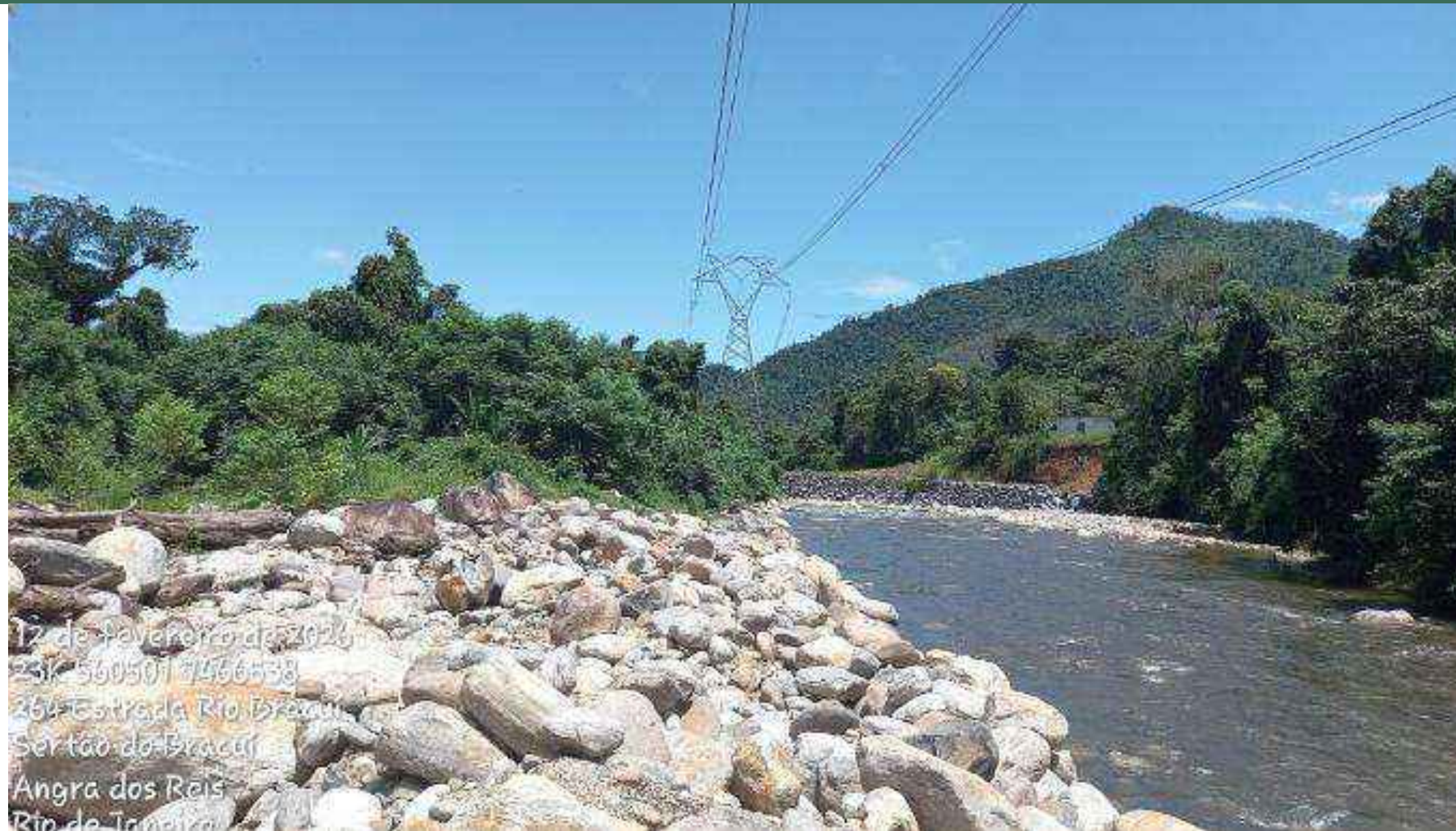
Enrocamento a ser refeito.
