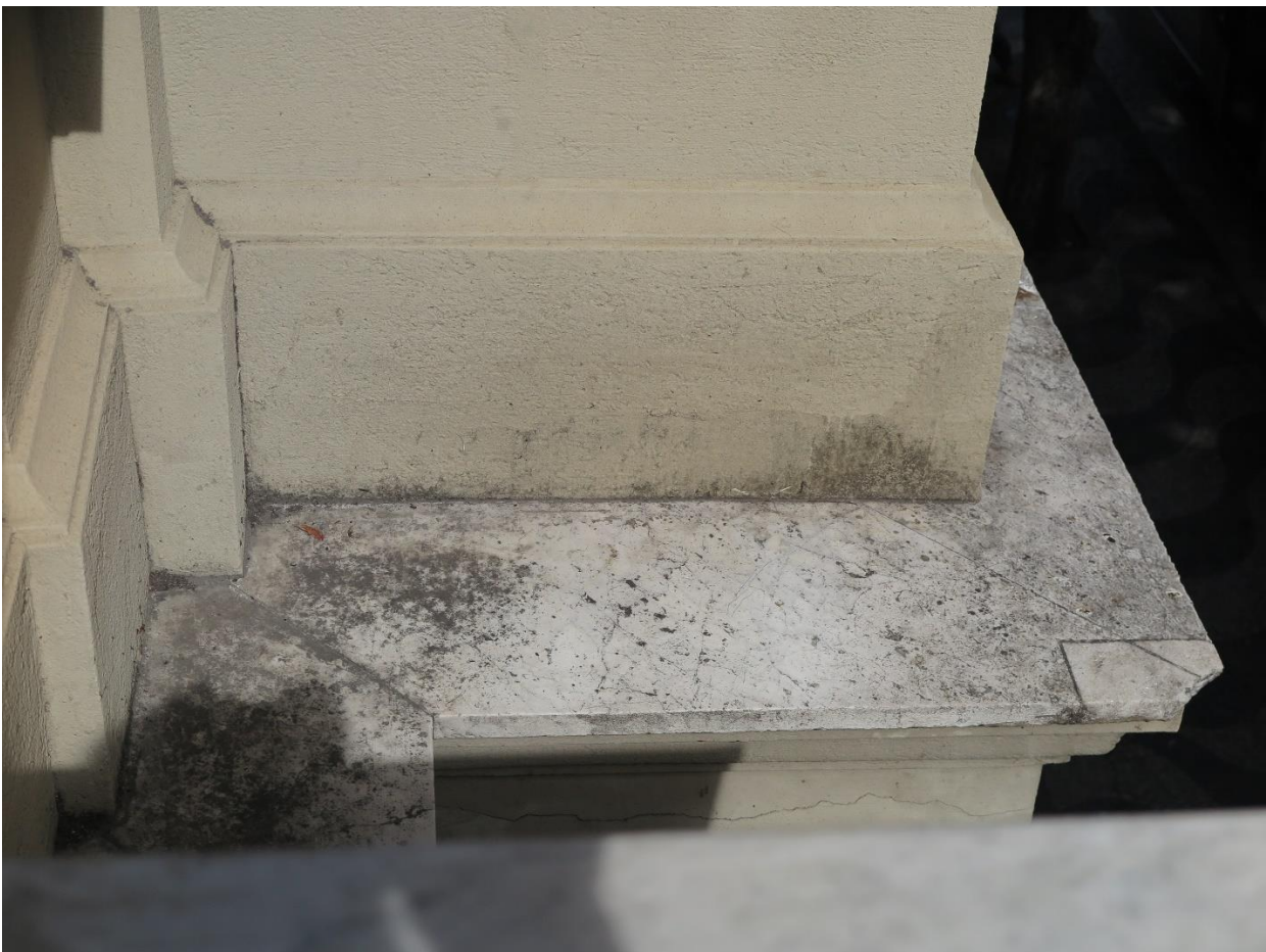
Foto 16: Danos Gerais levantados: Infiltração, fissuras e perda de parte do mármore da platibanda.
