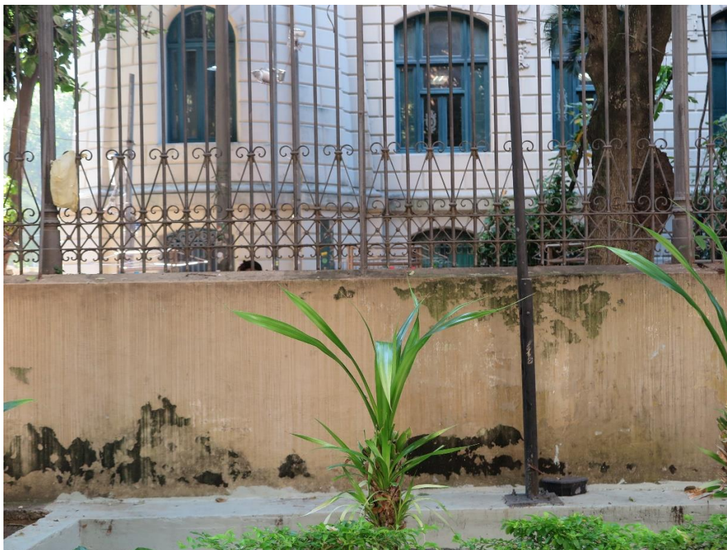
Foto 23: Danos Gerais levantados: Deterioração da pintura, musgos e infiltração no muro contíguo a fachada. Gradil com ferrugem e pontos de fixação comprometidos.
