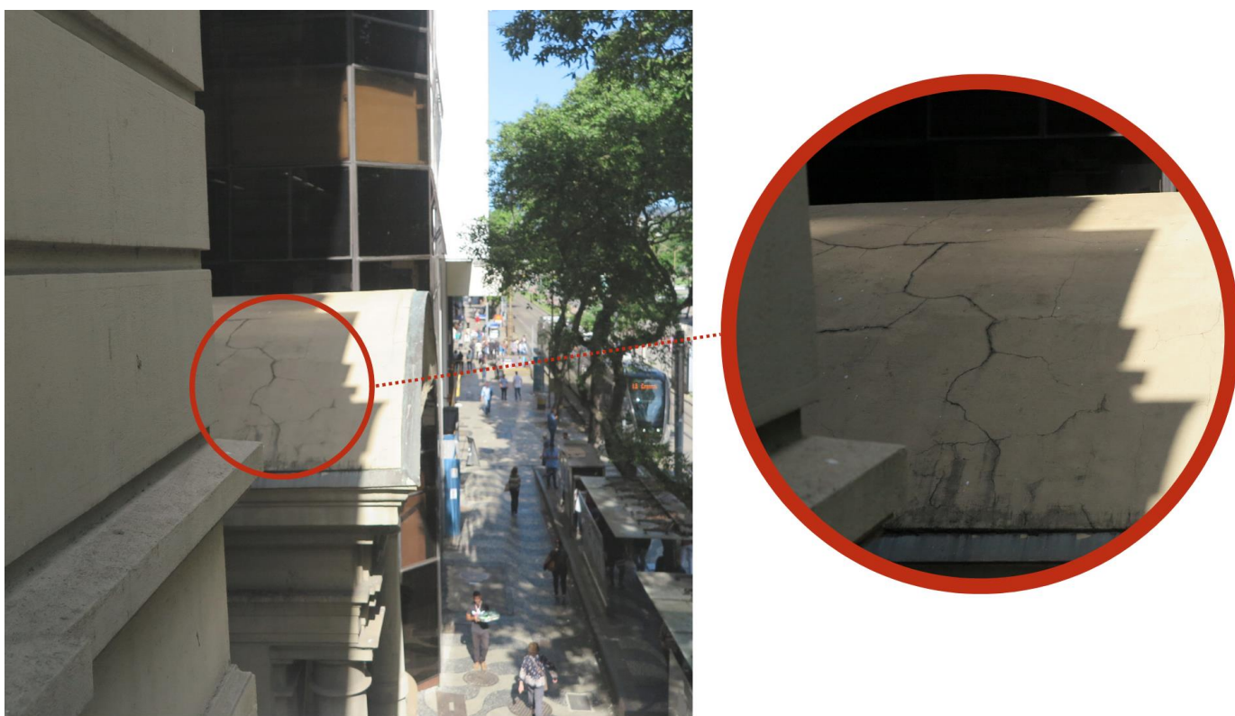
Foto 8: Detalhamento de Danos: Várias trincas e fissuras na cobertura do pórtico esquerdo, gerando infiltração na alvenaria.
