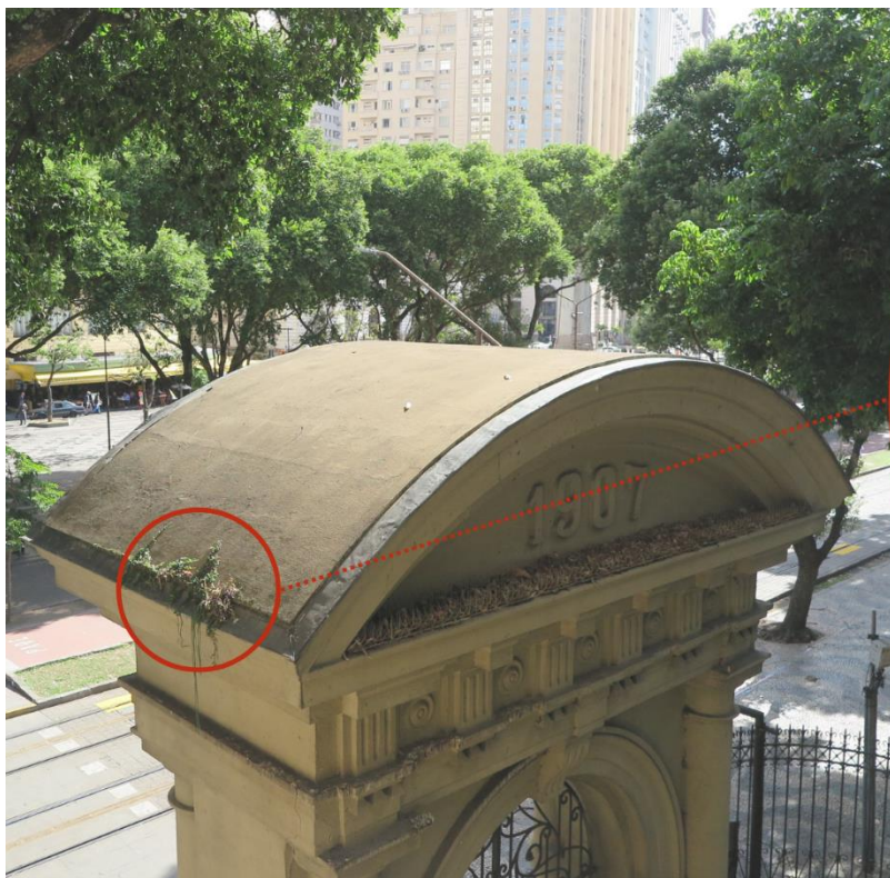
Foto 9: Detalhamento de Danos: Desenvolvimento de musgos e vegetação invasiva, gerando infiltração na argamassa.
