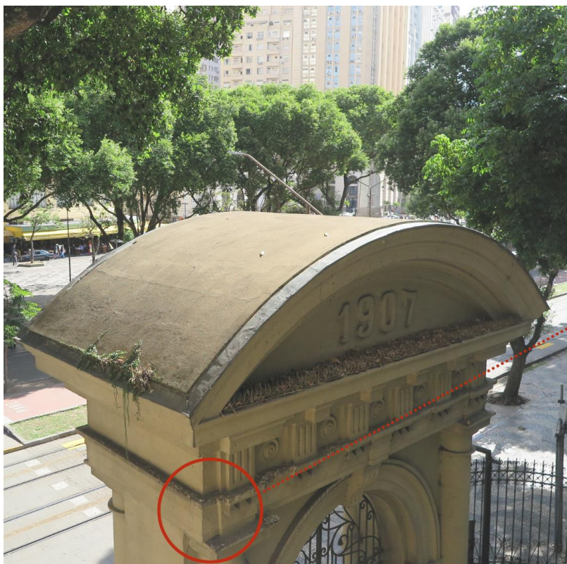
Foto 6: Detalhamento de Danos: Trinca grave na argamassa, com outras fissuras menores, gerando infiltração na alvenaria, perigo de queda de partes de argamassa.
