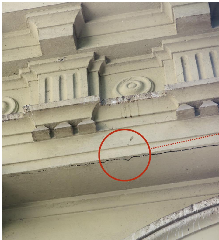
Foto 11: Detalhamento de Danos: Trinca grave na argamassa, gerando infiltração na alvenaria, perigo de queda de partes de argamassa.
