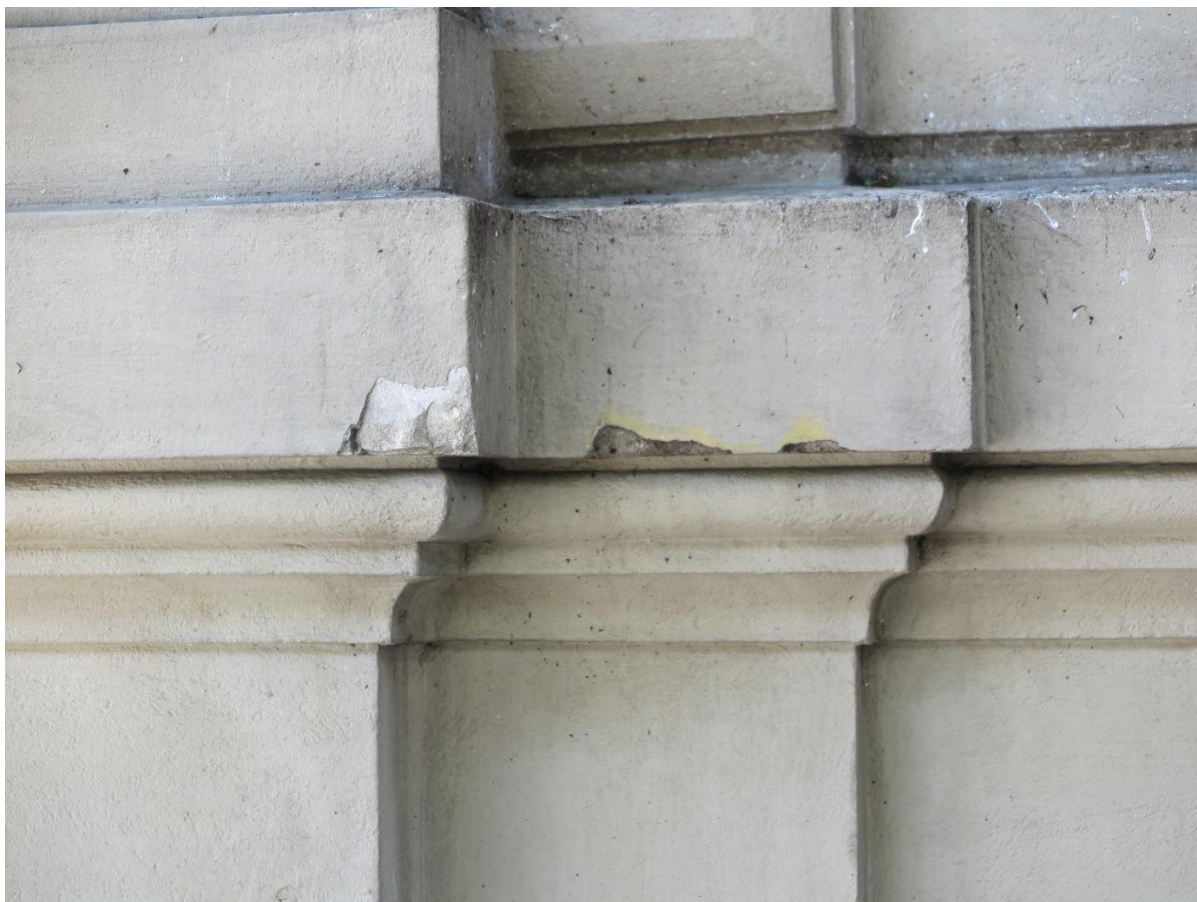
Foto 14: Danos Gerais levantados: Elementos Arquitetônicos quebrado.
