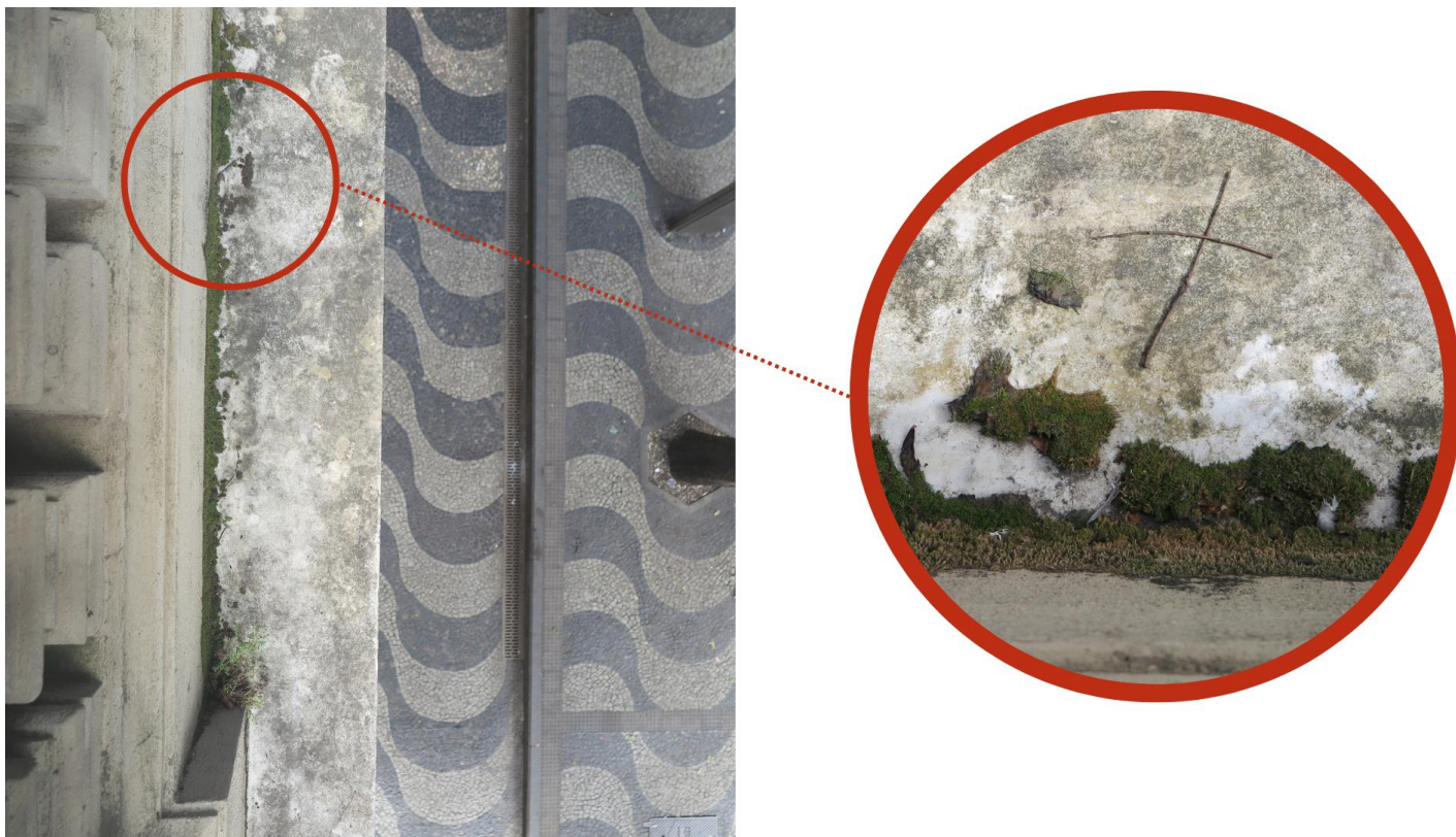
Foto 7: Detalhamento de Danos: Desenvolvimento de musgos, inexistência de camada de revestimento protetivo, fragilizando a platibanda gerando infiltração na alvenaria.
