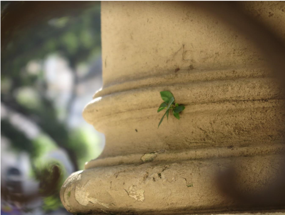
Foto 21: Danos Gerais levantados: Desprendimento de pintura e vegetação invasiva.
