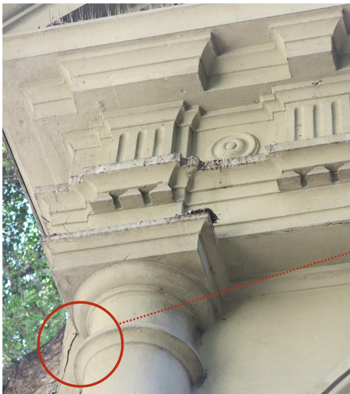
Foto 5: Detalhamento de Danos: Trinca grave na argamassa, com outras fissuras menores, gerando infiltração na alvenaria, perigo de queda de partes de argamassa.
