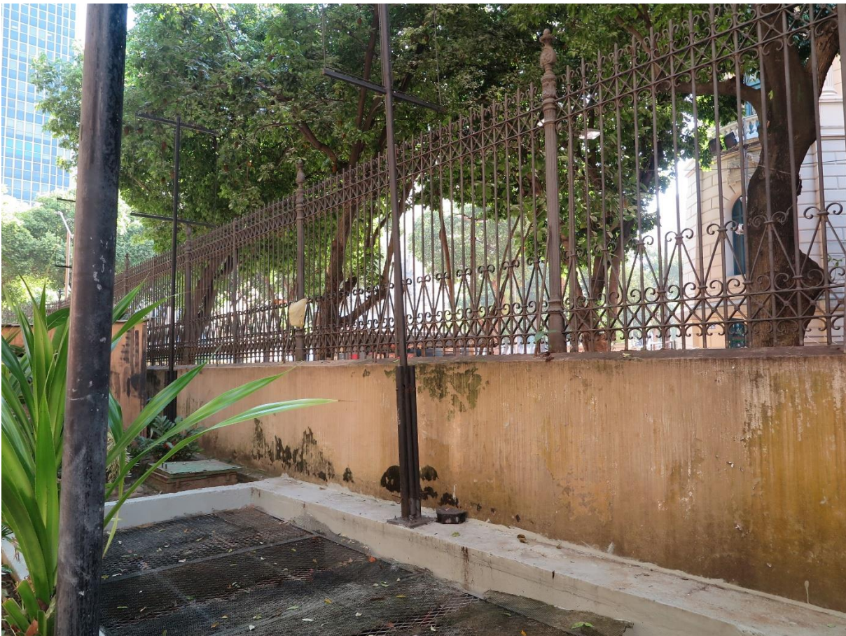
Foto 22: Danos Gerais levantados: Deterioração da pintura, musgos e infiltração no muro contíguo a fachada. Gradil com ferrugem e pontos de fixação comprometidos.
