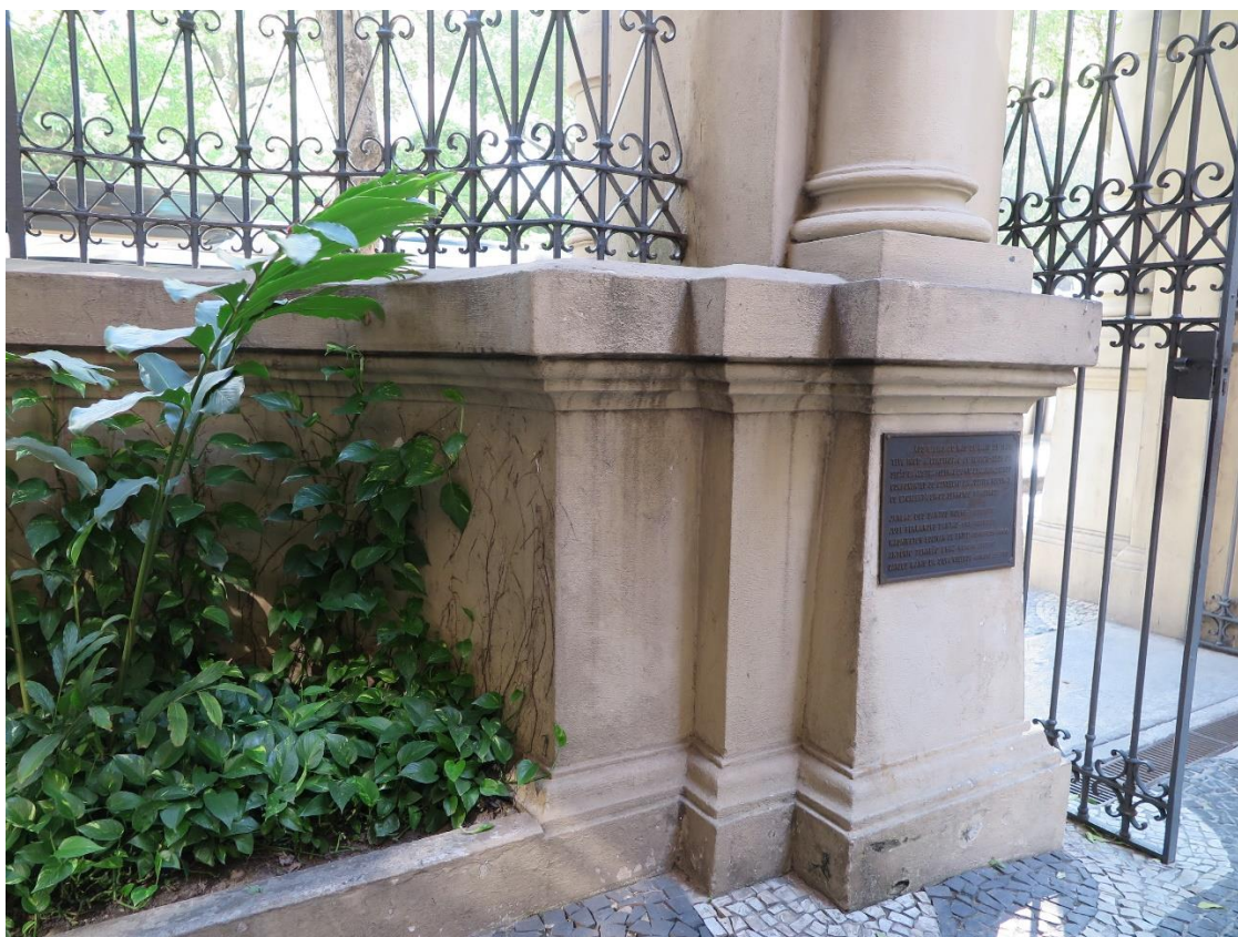
Foto 24: Danos Gerais levantados: Deterioração da pintura, infiltração no muro contíguo a fachada, pórtico e portão a serem recuperados. Gradil com ferrugem e pontos de fixação comprometidos.
