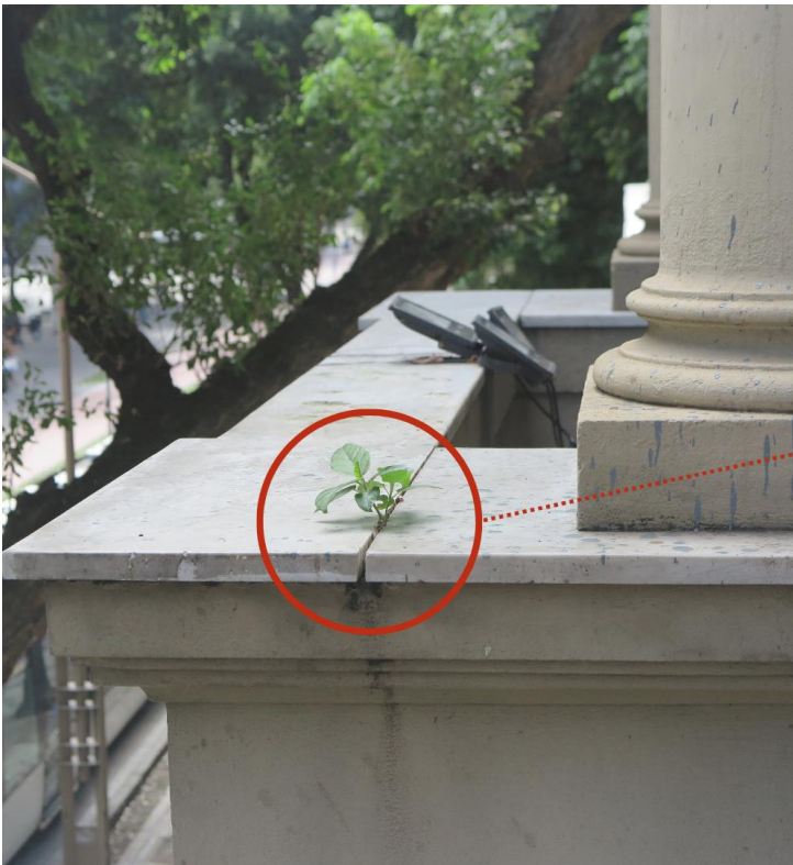
Foto 4: Detalhamento de Danos: Vegetação invasiva gerando despendimento do mármore e infiltração na alvenaria.
